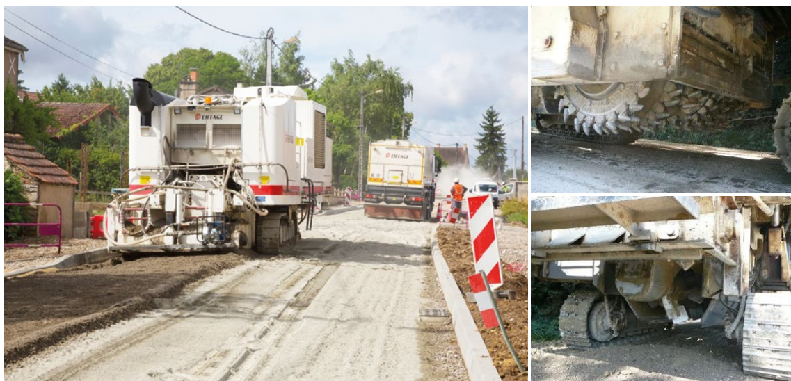
Mise en œuvre du procédé innovant dans le cadre des travaux d'entretien de la traversée de Demigny
