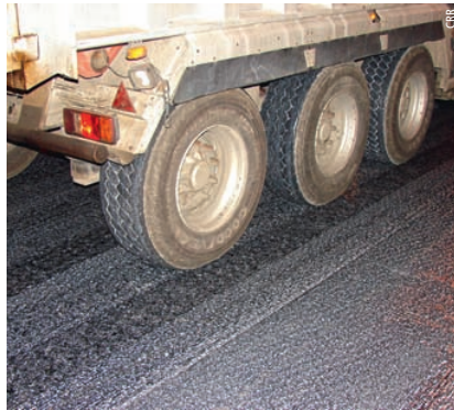
Photo 4 Application du lait de chaux stabilisé dilué sur la couche d'accrochage à 250 g/m 2 de bitume résiduel sur un support fraisé lors du chantier de la N25.
